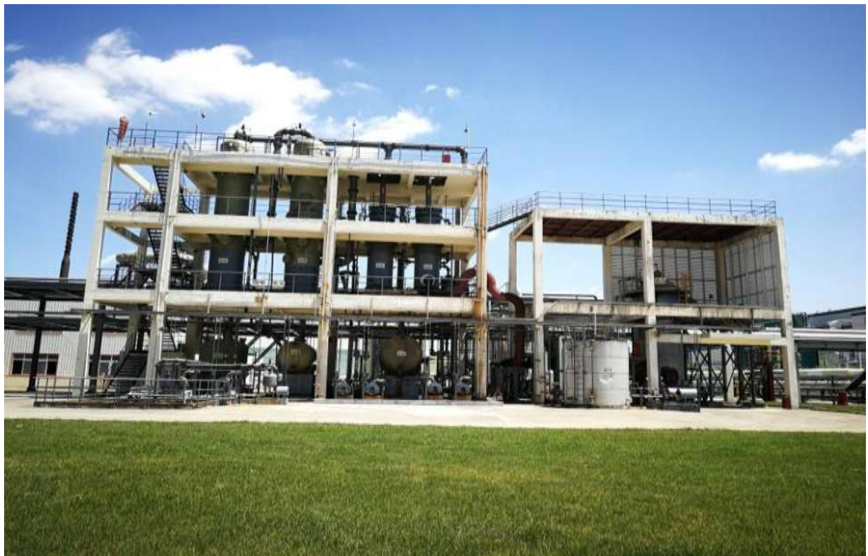
焚烧装置全景
